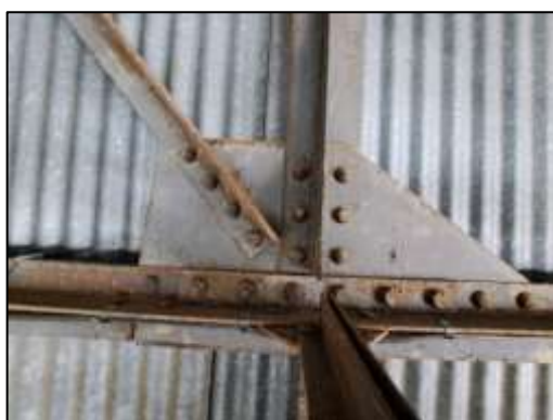
1 – Protection globalement en bon état
