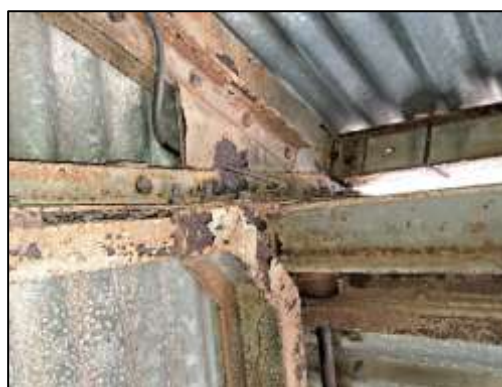
2 – Traces de corrosion sur la charpente
