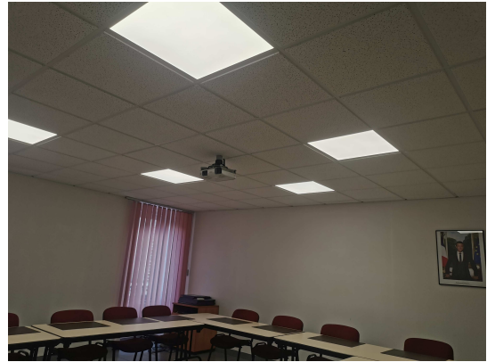
Chanteloup les Bois – Passage en dalle LED dans la salle du conseil
