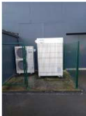
Cléré-sur-Layon – Nouveau mode de chauffage de la salle des fêtes avec une pompe a chaleur air air
