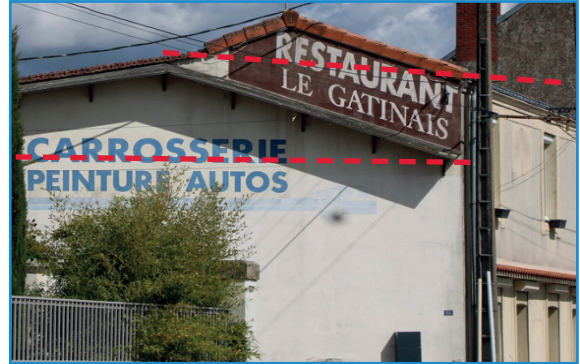
Enseignes apposées à plat dépassant les limites de l'égoût du toit (article R. 581-60 du Code de l'environnement)
