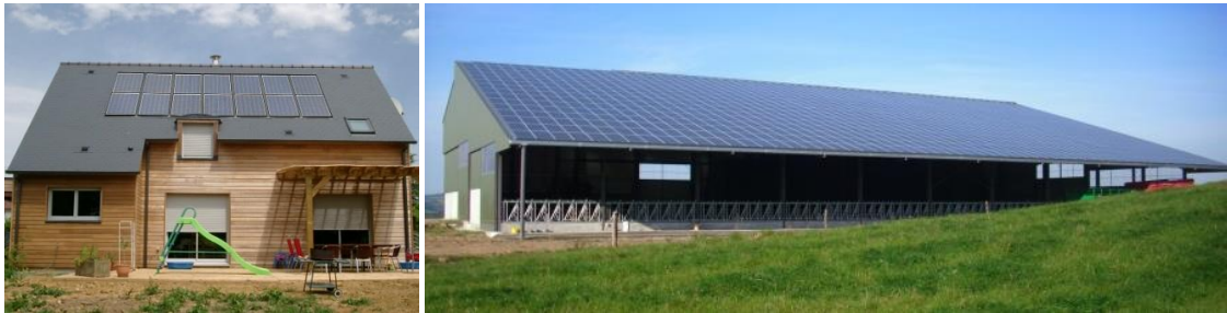
Exemples de dispositifs photovoltaïques installés sur la toiture d'une maison individuelle (intégration dans la toiture en ardoise) et d'un hangar agricole.
