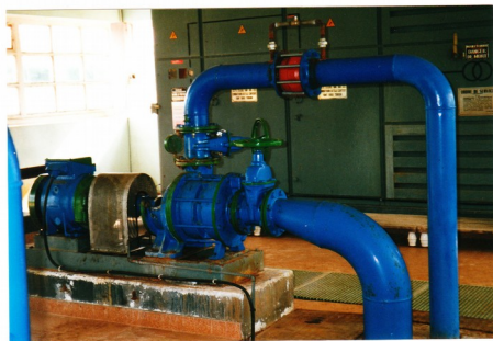
Juillet 2000 – Partie d'une vue intérieure de la station de pompage de la Rucette.
